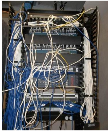
Figura 2 Sistema de Telecom del Hospital
